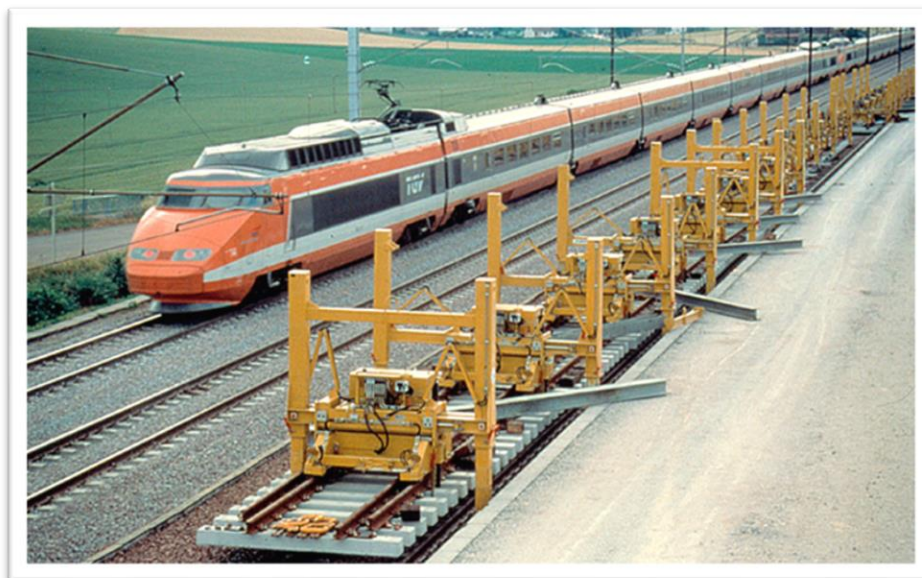
Les premiers PEM Geismar aux abords d'une ligne TGV en cours de rénovation (1996)
